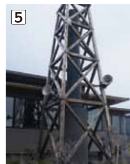
園地内放送設備
