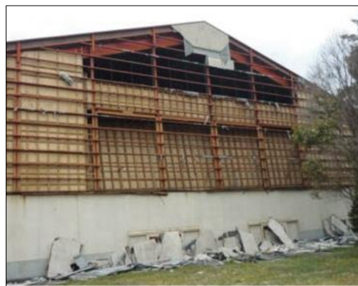
外装材の脱落
