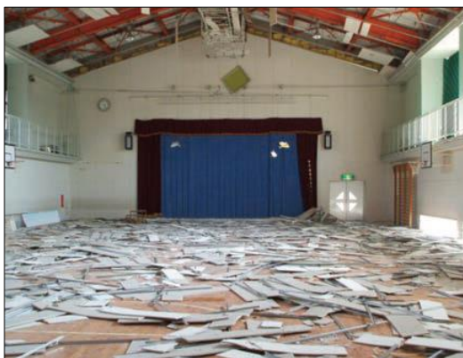
屋内運動場の天井材の脱落
