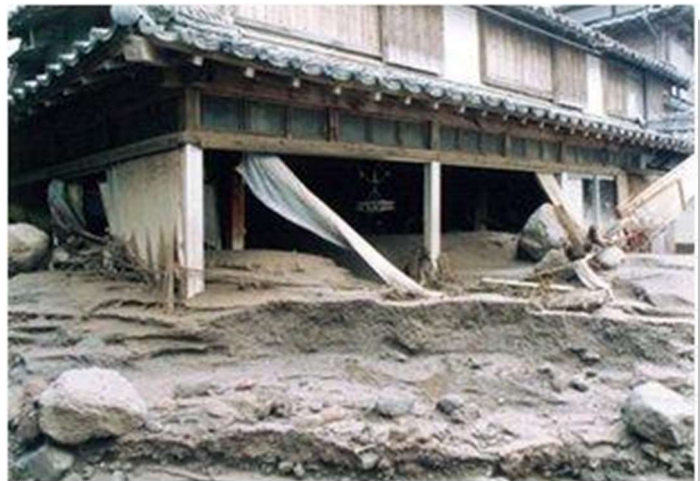
写真 4 土石流被害を受けた家屋 （国土交通省九州地方整備局雲仙復興事務所提供）
