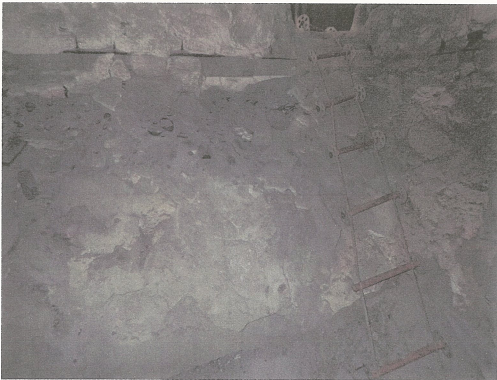
反給じん口側耐火物 損傷状況
