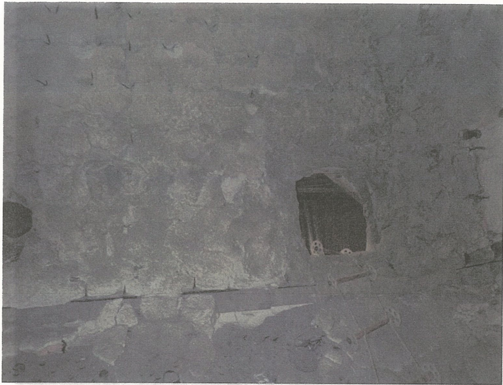
反給じん口側耐火物 損傷状況
