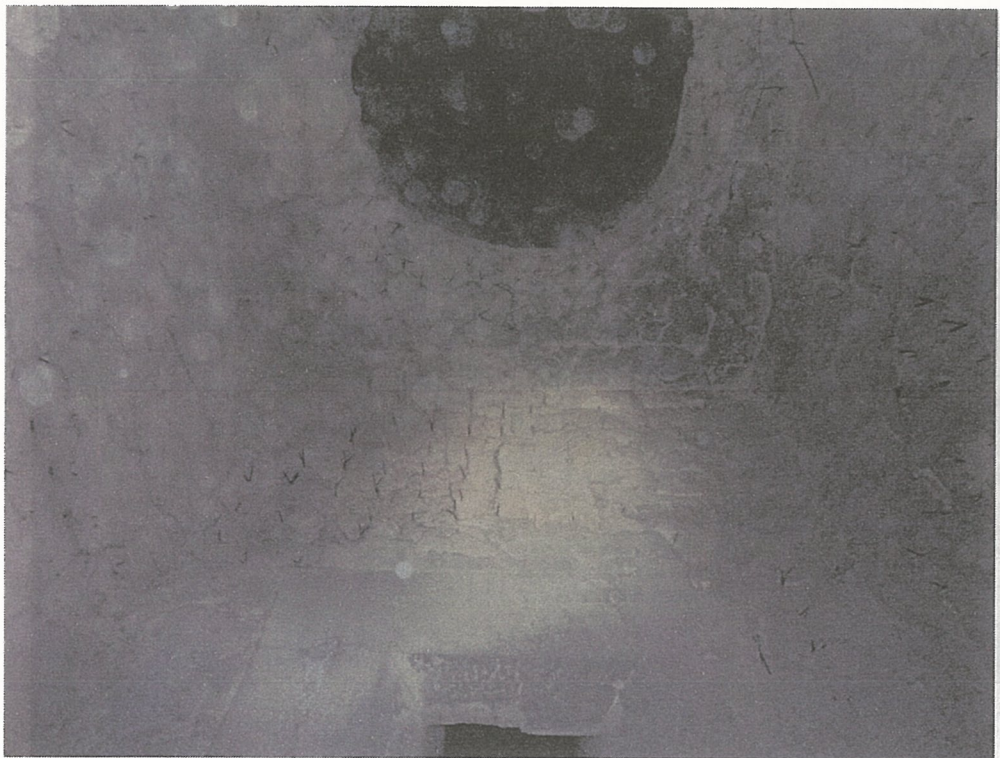
給じん側耐火物 損傷状況
