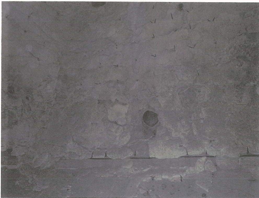
反給じん口側耐火物 損傷状況
