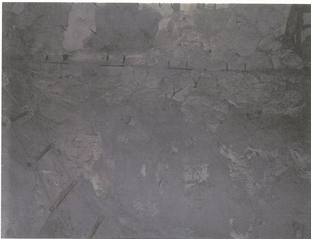
助燃バーナ側耐火物 損傷状況
