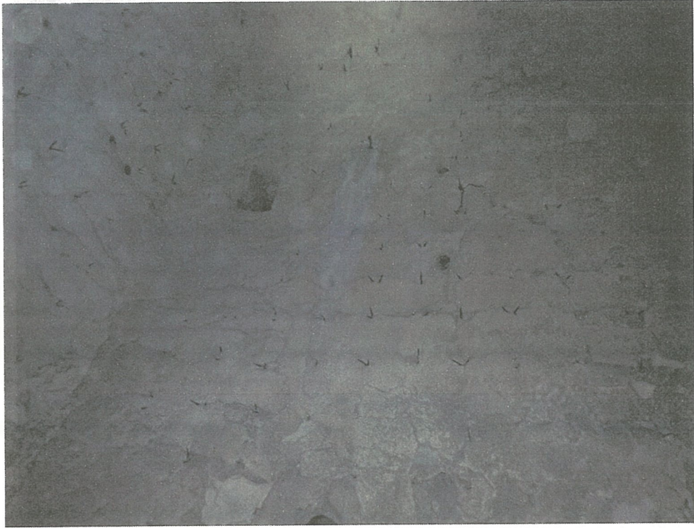
反給じん口側耐火物 損傷状況
