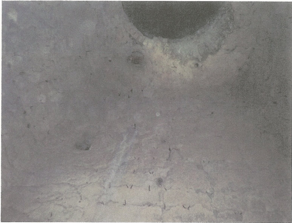
マンホール側天井部耐火物 損状状況
