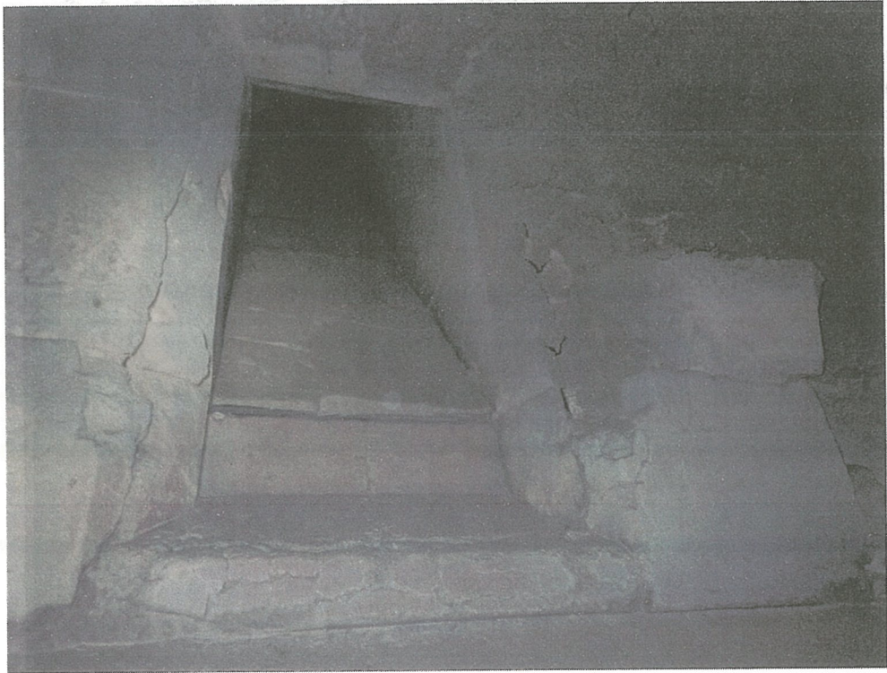
給じん側耐火物 損傷状況
