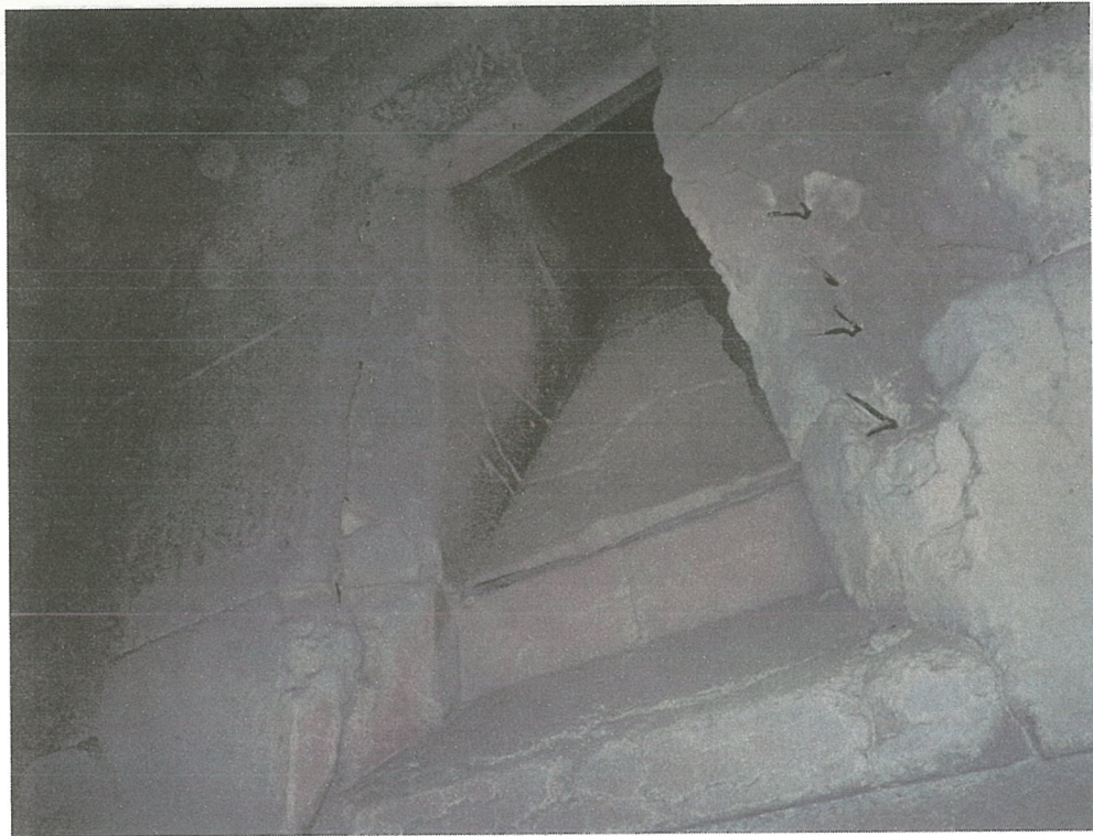
給じん側耐火物 損傷状況
