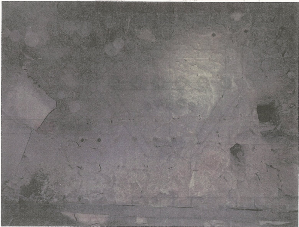
反助燃バーナ側耐火物 損傷状況
