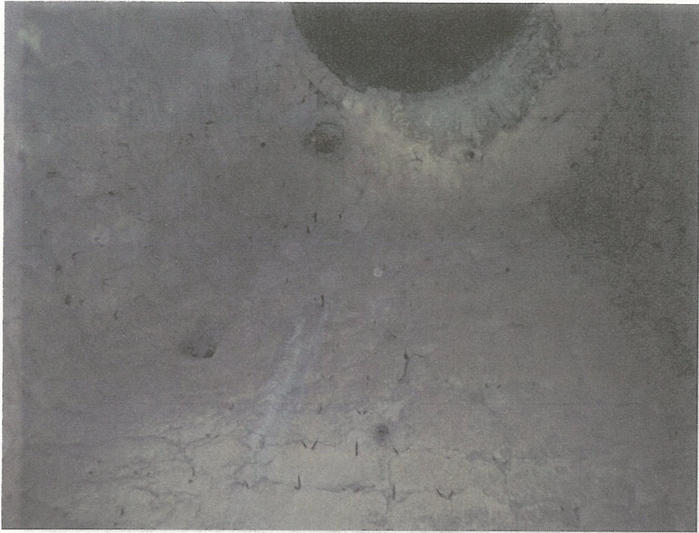
反給じん口側耐火物 損傷状況
