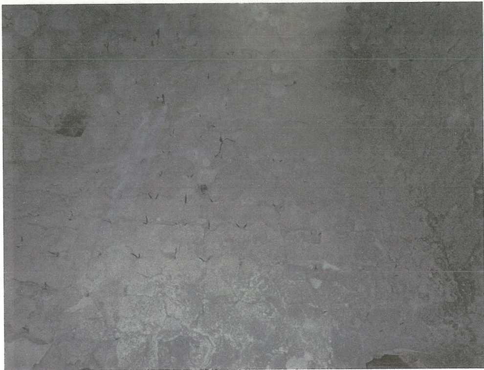
反給じん口側耐火物 損傷状況
