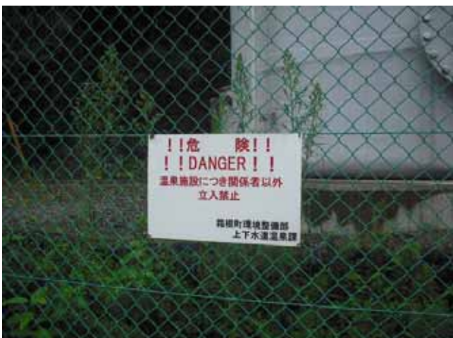
箱根配湯槽 箱根ポンプ 立入禁止の注意喚起
